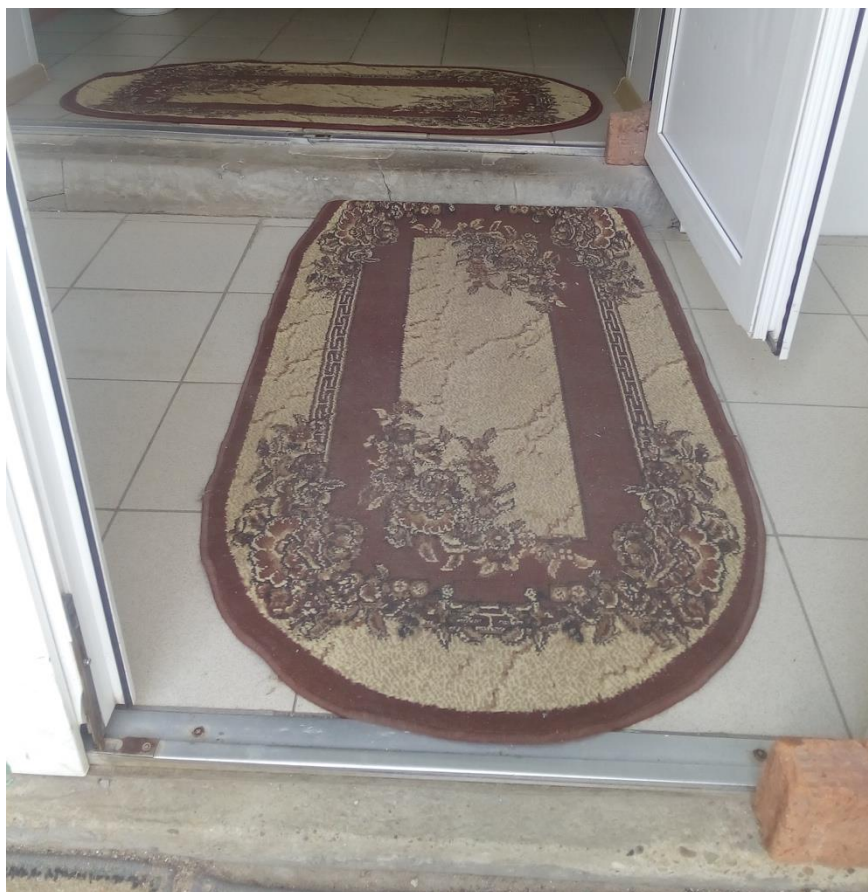
Рис. 16 – Красновишерский ДППИ. Отсутствие доступной среды.
